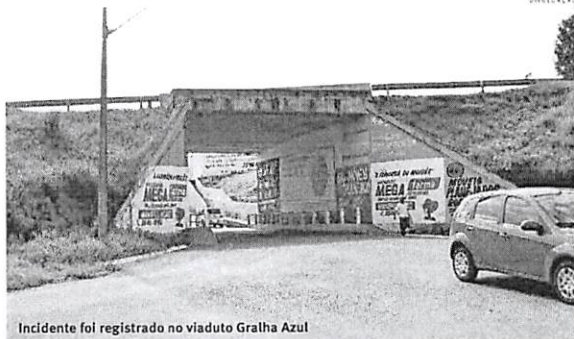
Incidente foi registrado no viaduto Galha Azul
